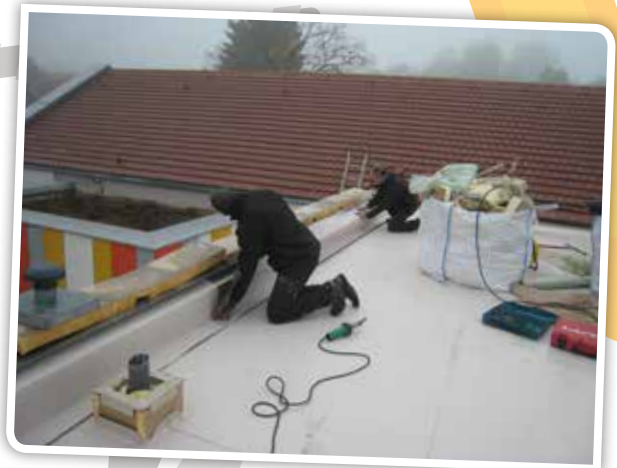
Étanchéité du toit de l'école maternelle
