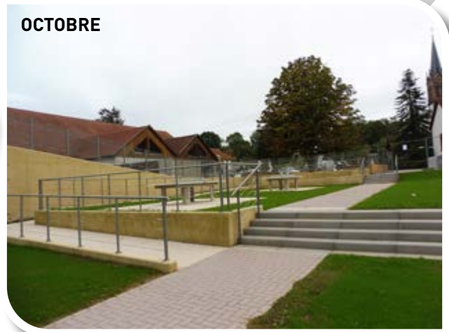
Les travaux sont finis ! Il faut juste un peu de patience pour laisser pousser l'herbe avant de la fouler !
