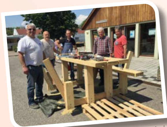
Montage d'une table avec deux bancs en bois de robinier (faux acacia), bois imputrescible
