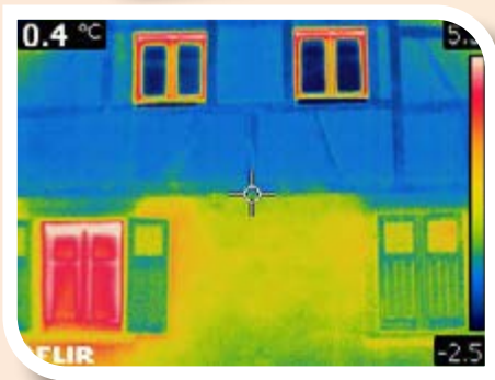
Différence de chaleur entre le rez-de-chaussée chauffé et le 1 er étage qui ne l'est pas.
